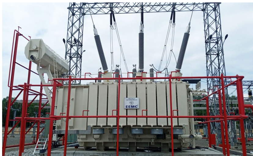
Hình 3.32: Trạm biến áp 220kV 500MVA Kiên Bình
