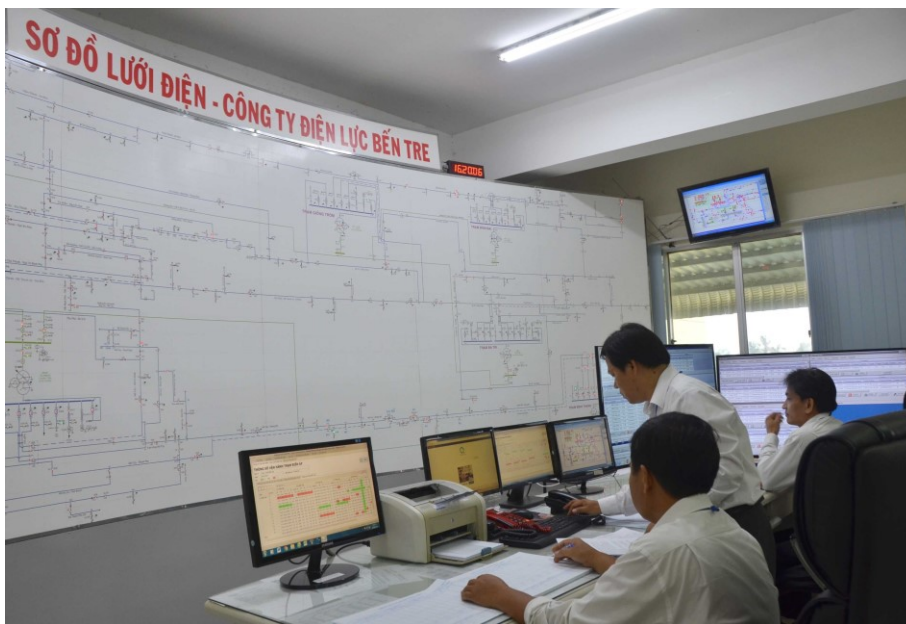
Hình ảnh phòng điều độ điện lực tỉnh Bến Tre
