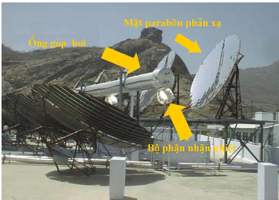
Hình 4.40. Hệ thống cấp hơi nước sử dụng NLMT
