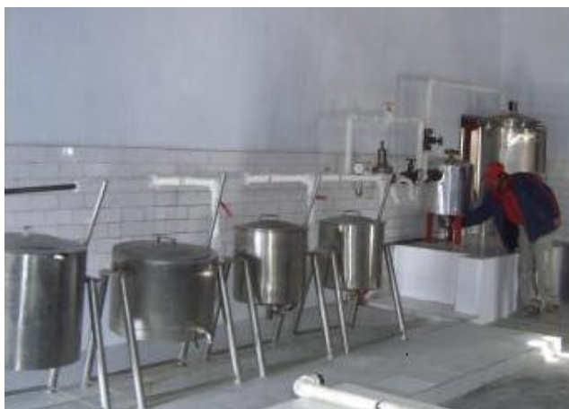
Hình 4.41. Hệ thống nồi nấu bằng hơi nước
